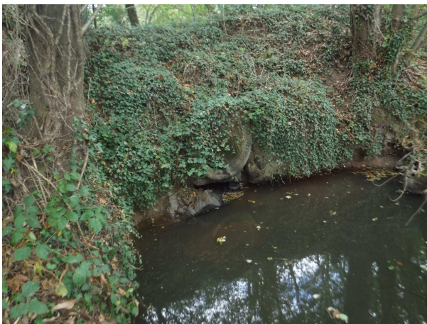
Sortie du busage, avec une fosse de plus de 1.1m
