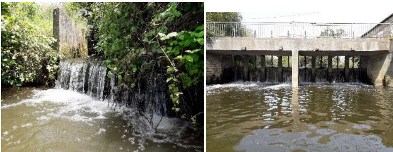
Figure 71 : Situations dégradées sur le territoire d'étude – Source : HARDY ENVIRONNEMENT
