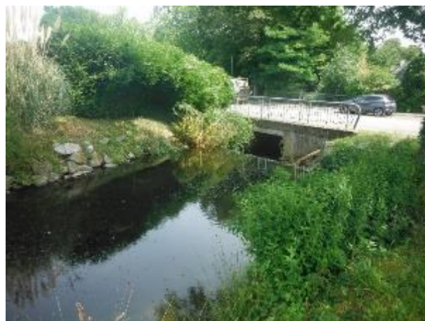
Figure 69 : Situation dégradée sur le territoire d'étude – Source : HARDY ENVIRONNEMENT
