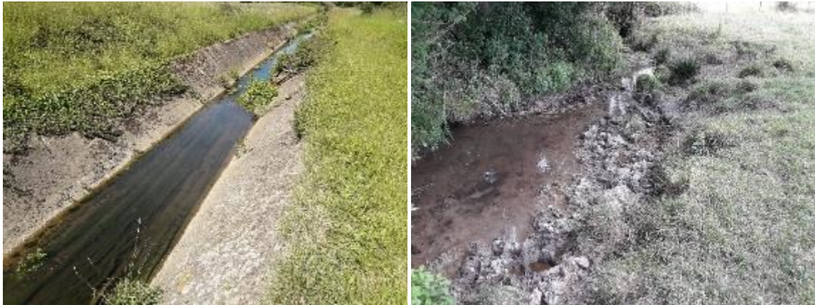
Figure 61 : Situations dégradées sur le territoire d'étude - Source : HARDY ENVIRONNEMENT
