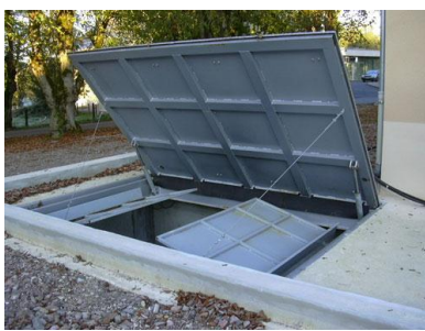
Trappe sur vérins hydrauliques (source Compte.R)
